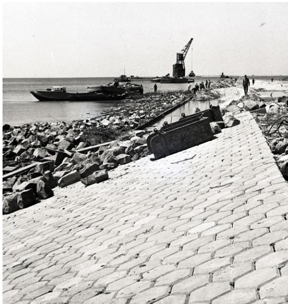
Uitvoeringswerken van de dijkbekleding ten tijde van de aanleg van de IJsselmeerdijken (Beeldbank Rijkswaterstaat)
